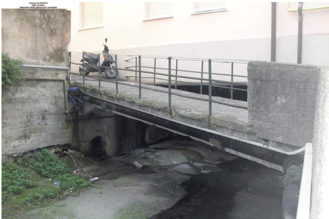
Foto "1": canalizzazioni e sottoservizi sostenuti dalle strutture in c.a. della passerella carrabile tra via Oliveto e via Rossetti.
